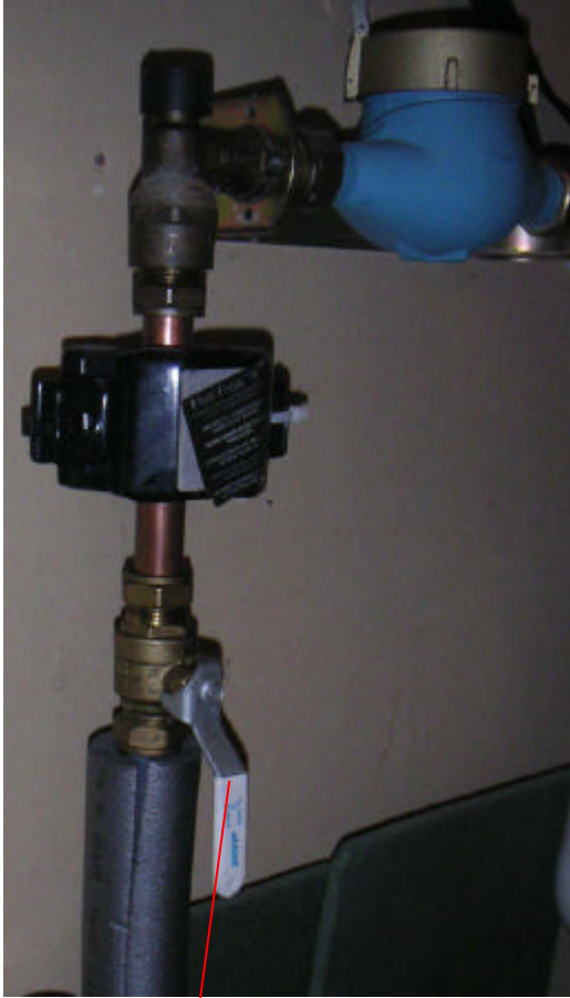
Huvudavstängningred för vatten i huset.
